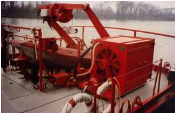
Achterdeck mit Hebebock und Leichtschaumgenerator
