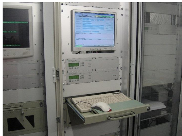
Brandmelde-Empfangstechnik im Keller des BKRZ
