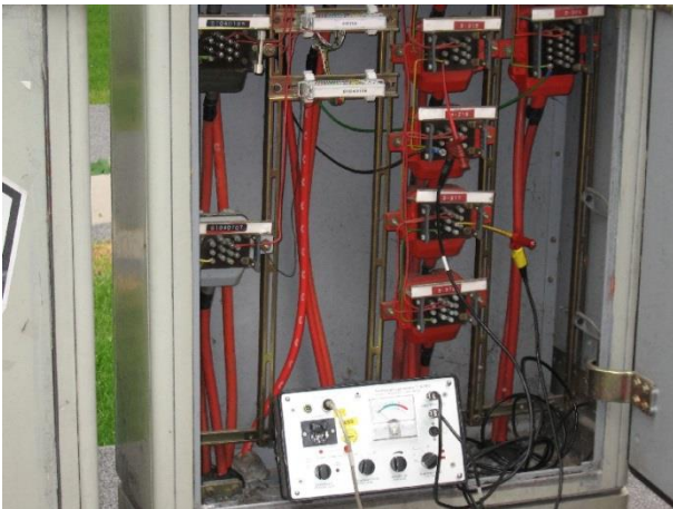
„Kabelverteilerschrank“ des Feuermeldekabelnetzes mit angeschlossenem Prüfgerät. Derzeit sind über 330 solcher Verteiler im Stadtgebiet Frankfurt aufgestellt.
