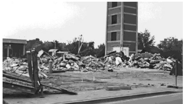
Abriss des alten Gerätehauses am Florianweg im Jahr 1975. Der erste Bauabschnitt steht schon (im Hintergrund links); hier zieht die FF erstmal bis zum Abschluss der Bauarbeiten ein
