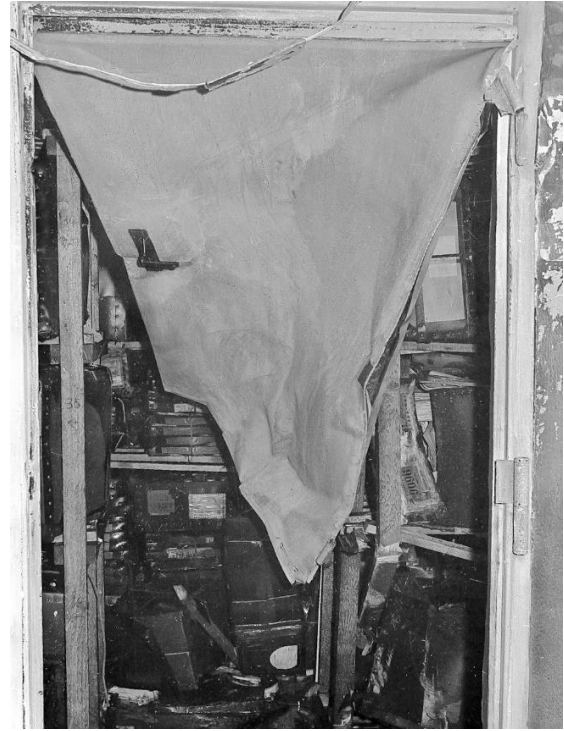
Von der Druckwelle verformte Stahltür im Treppenhaus des Lagergebäudes.
