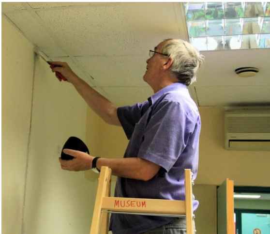
18. Juli: Mit ersten Spachtelarbeiten im Erdgeschoss eröffnet Udo Blecker die Renovierung des Gebäudes
