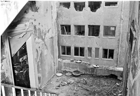
Herausgesprengte Mauer des Treppenhauses mit Blick auf das Gebäude der Firma Delliehausen.
