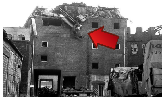
Aufzugsmaschine droht abzustürzen.
